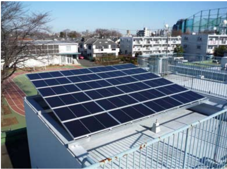
写真2 市民発電所3号機「三育」(東京三育小学校屋上)
