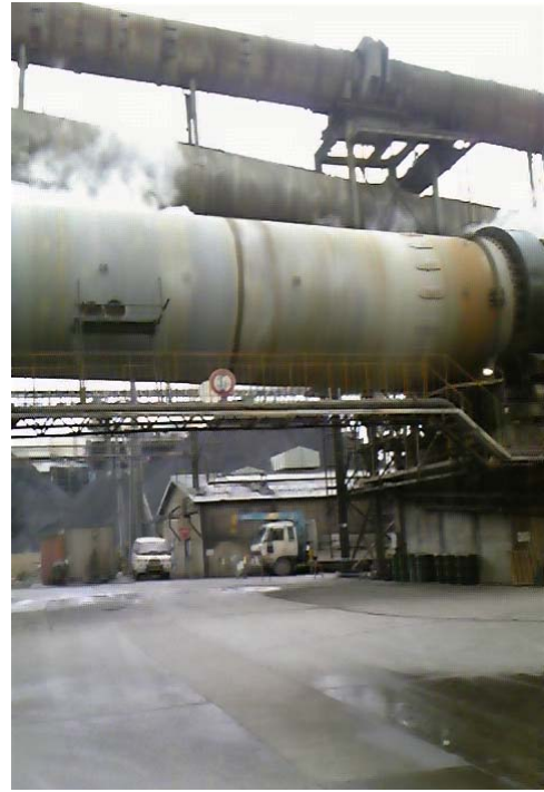
写真-2 セメント焼成ロータリーキルン
