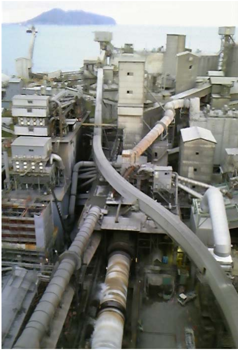
写真-1 海上ポートから上磯工場に伸びる原料輸送管
