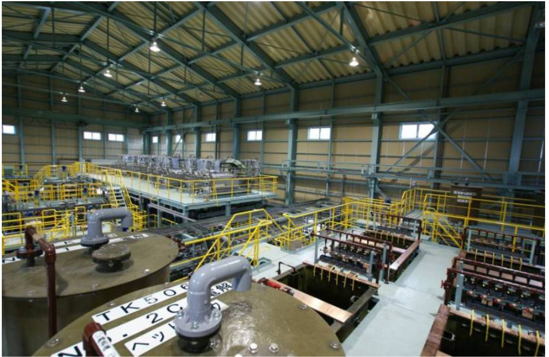
電池リサイクル工場設備（ろ過・電解設備）
