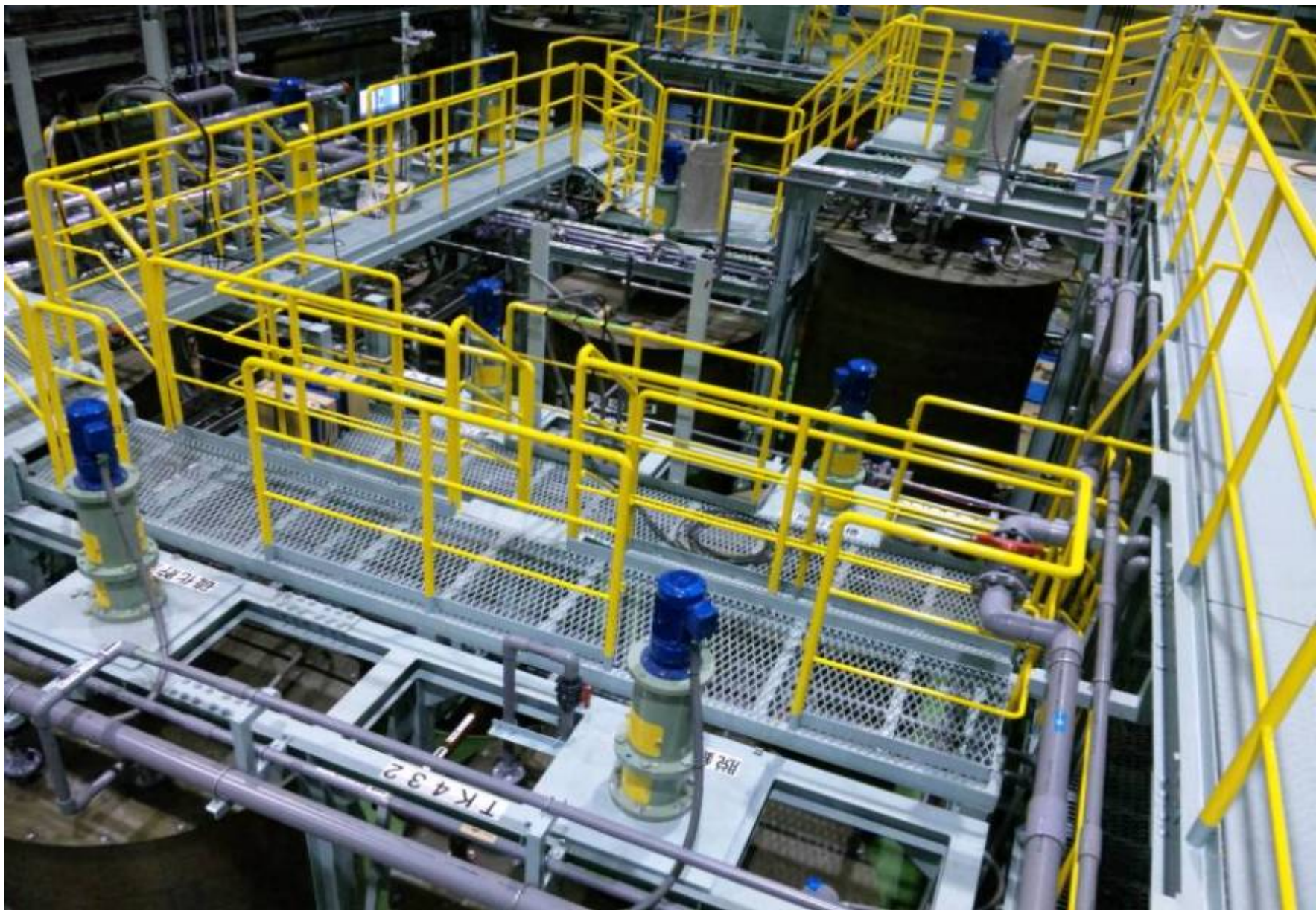
電池リサイクル工場設備（浸出・精製設備）
