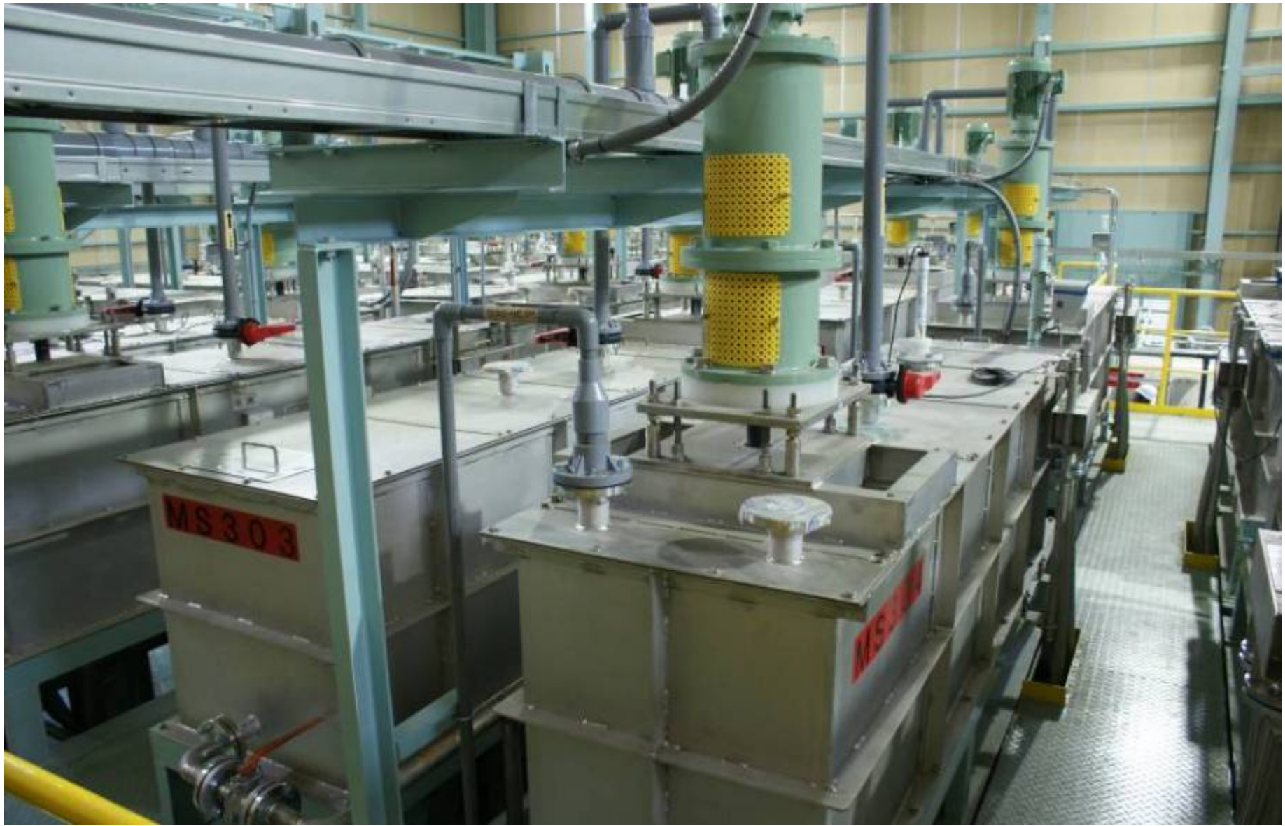
電池リサイクル工場設備（溶媒抽出設備）
