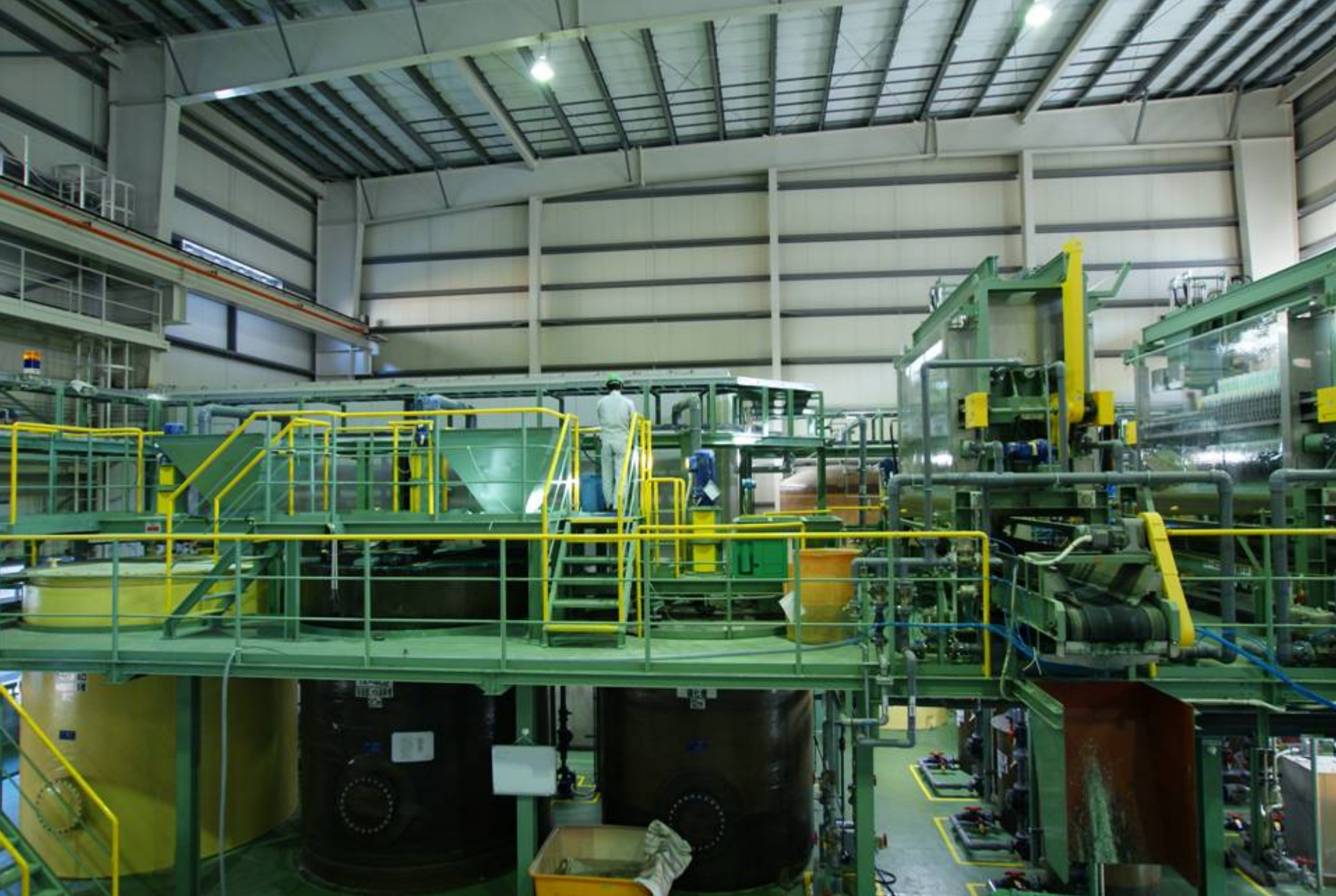
ニッケルの湿式リサイクル設備
