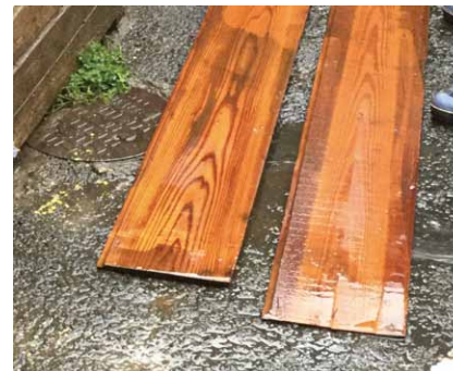
写真9 高圧洗浄で研磨すると、表面が薄く削れて木目が出てくる。いくらでも磨けるのでキリがない
