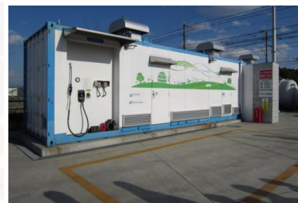
図-5 水素ステーションの外観
