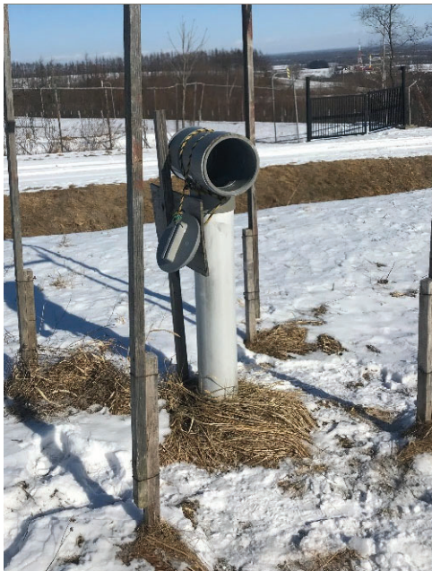
ガス抜き管（観測孔）
