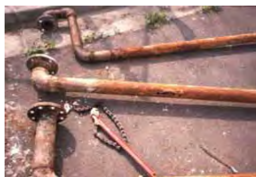
写真 4 塩害による金属腐蝕
