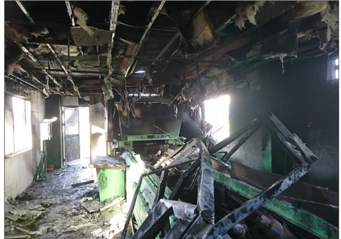
●リチウムイオン電池の発火が原因で、リサイクル工場の建屋・設備が焼けてしまった事例
