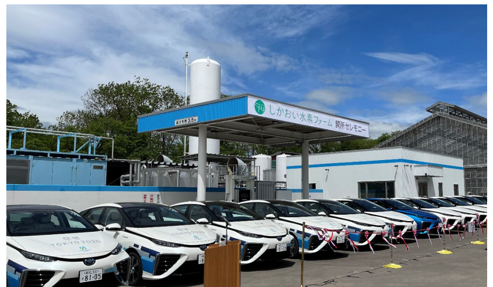
▲しかおい水素ファームの水素製造設備／水素ステーション
