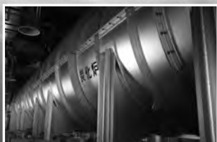
下水汚泥燃料化施設
