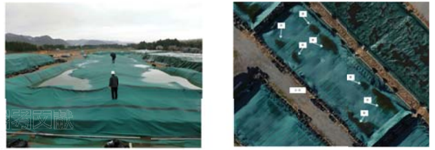
図7 キャッピング上部の雨水溜りの様子
