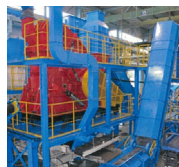
金属破碎・選別設備
