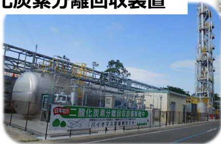
二酸化炭素分離回収装置
