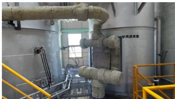
高温AH外周り
