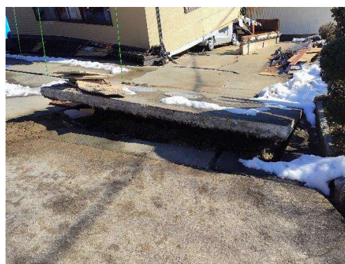
地震により浮き上がった浄化槽（画像は珠洲市内の例）
