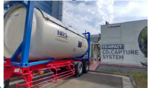
鶴見工場CO 2 回収・圧縮装置
